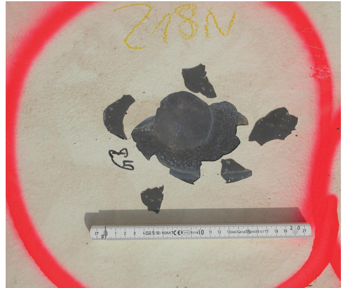
Beschichtungsschaden durch Blasenbildung und Abplatzung
