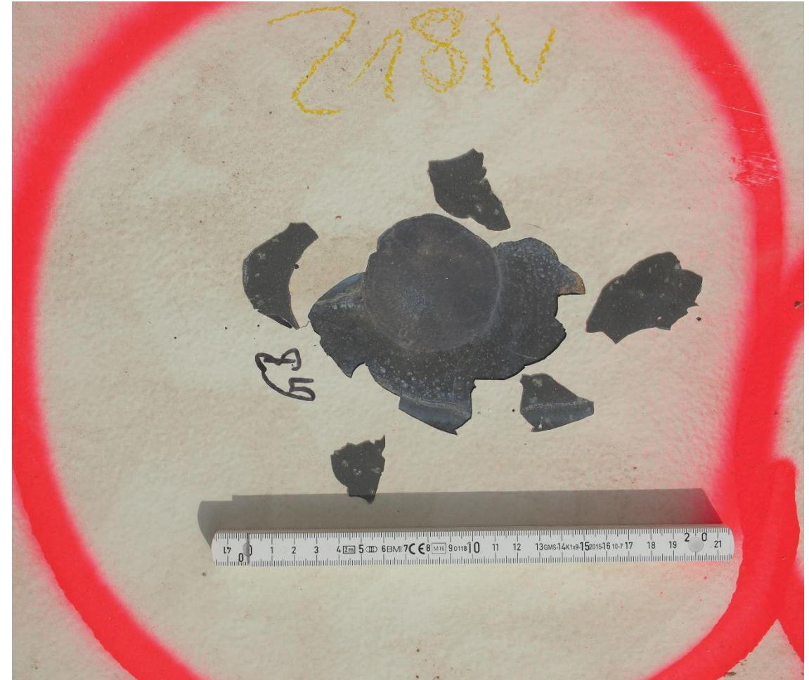
Beschichtungsschaden durch Blasenbildung und Abplatzung
